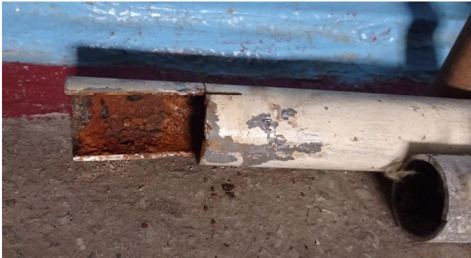
Рис. 1. Зріз внутрішньобудинкової труби опалення будинку
